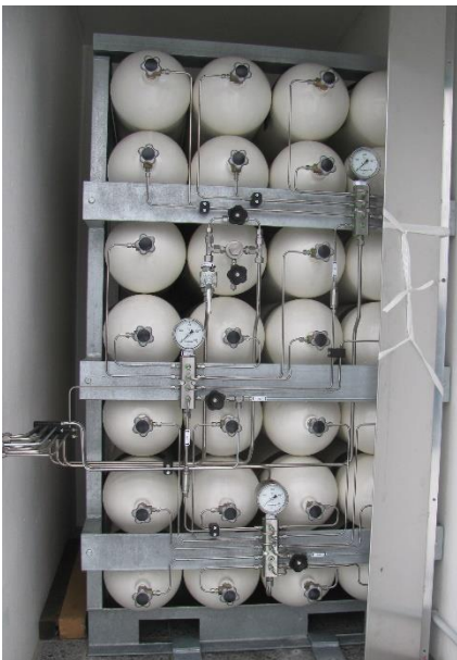
Pullopatteri jossa varastoidaan puhdistettua biokaasua
